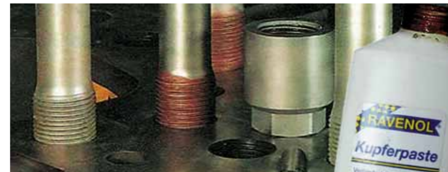
Болты обшивки турбин на электростанции
